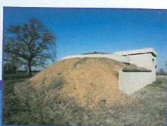
Réservoir semi-enterré «Le Champ de la Corne», Le Vilhain
